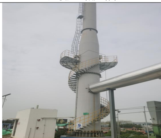
导热油炉废气排气筒
