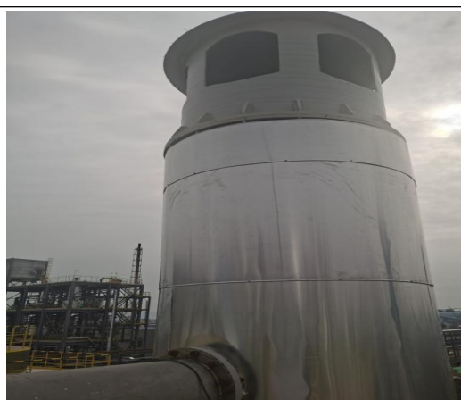
回收尾气排气筒
