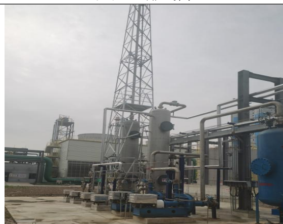
罐区废气排气筒
